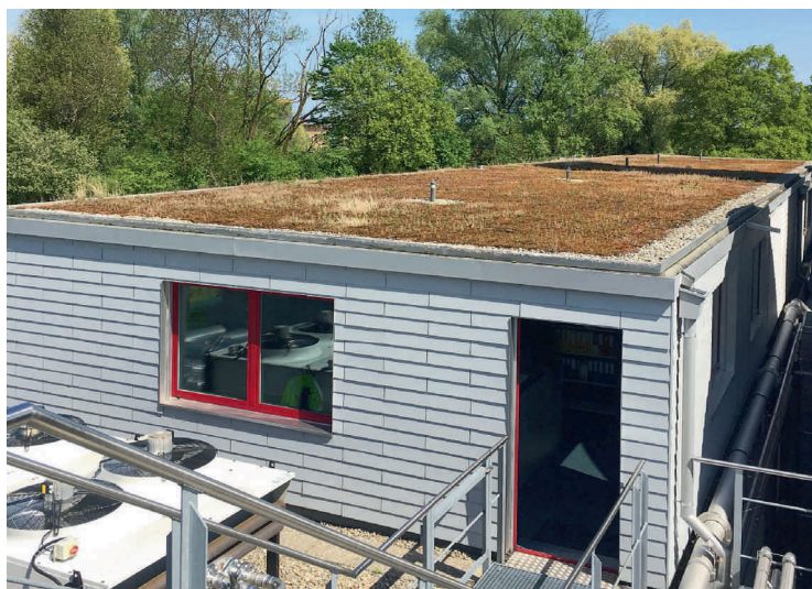
Fig. 4 Das Bürogebäude auf dem Areal Steinach des AVM wurde nachträglich begrünt, da sich die darunterliegenden Büroräume im Sommer zu stark erhitzten. Aufgrund der baulichen Voraussetzungen konnte nur eine geringe Substratschicht verwendet werden. Dies reichte jedoch bereits, um eine spürbare Abkühlung zu bringen.
